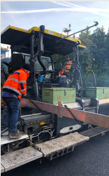
Abb. 01 Absaugeinrichtung an einem Straßenfertiger [Quelle: Autobahn GmbH]
