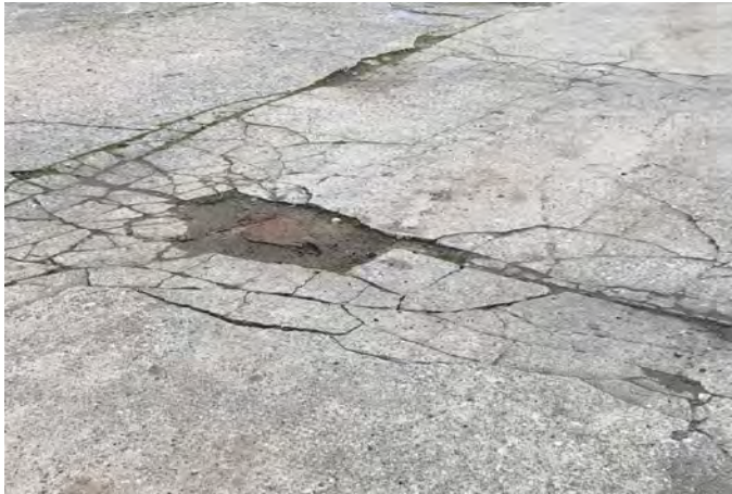
Abb. 02: Bestehende Ausbruchstelle in der betonierten Garagenzufahrt (provisorisch verfüllt)
