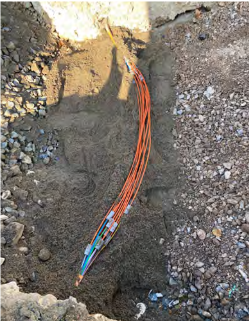
Abb. 02: Repariertes Glasfaserkabel mit mehreren eingespleißten Teilstücken
