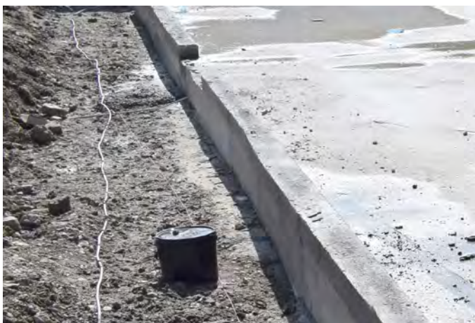
Abb. 01: Aufwölbung im Randbereich der Betonplatte
