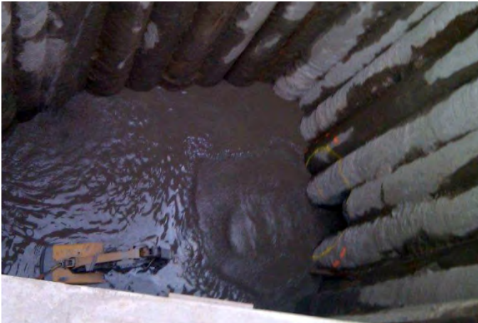
Abb. 02: Überflutete Baugrube mit Bagger
