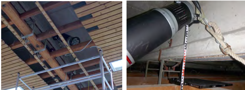
Abb. 04: Anordnung von Röntgenröhre und Digitaldetektor für die Durchstrahlungsprüfung (exemplarisch) [Quelle: bauray GmbH]
